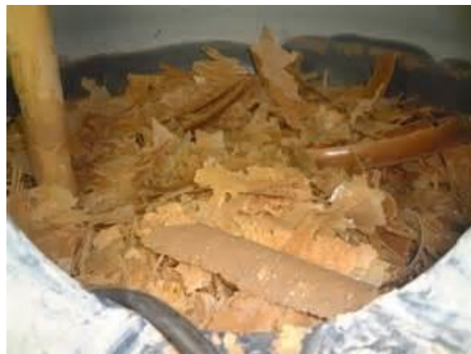
Kalk im Boilersumpf
